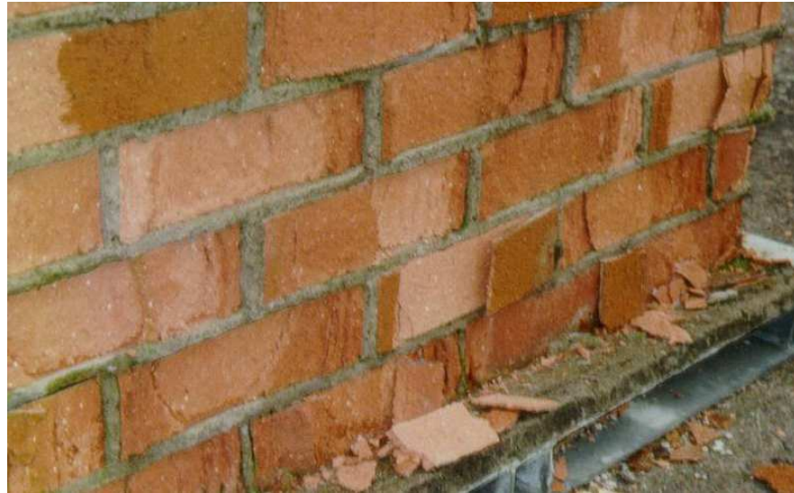
Briques soumises aux dégâts du gel - Source : A.Holm, Isolin
