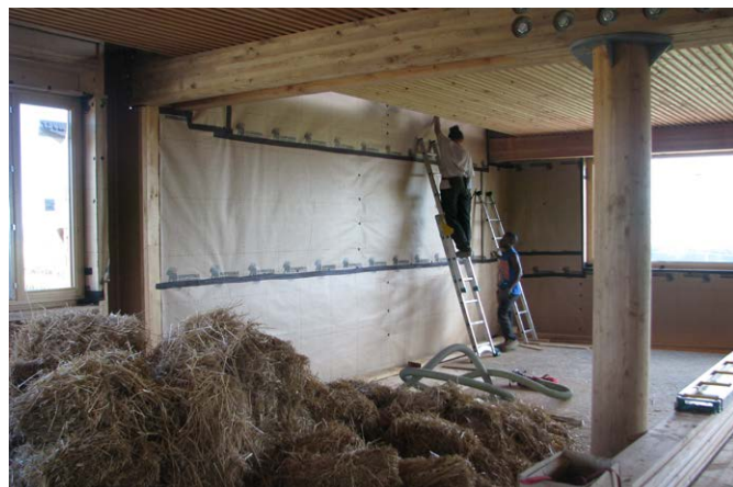
Mise en place des membranes d'étanchéité à l'air sur les murs-rideaux composés de caissons en bois isolés en bottes de paille. Bâtiment tertiaire (R+3) à énergie positive de la société Ecocert - L'isle-Jourdain (Gers). Crédit : Agence d'architecture JF. Collart
